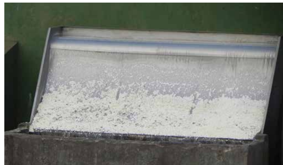
Figura 20 – Peneiramento – Tratamento preliminar | Fonte: Autores, 2014
