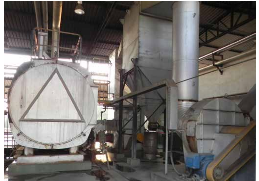
Figura 19 – Caldeira para geração de vapor, movida à lenha | Fonte: Autores, 2014
